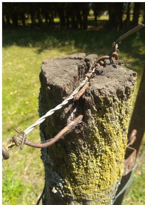
Cabeza de poste dañada
